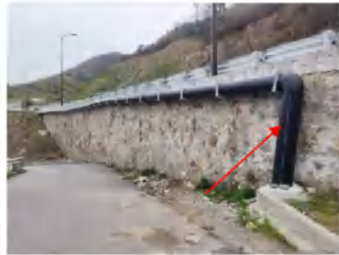
饮用水源集中排水管道
