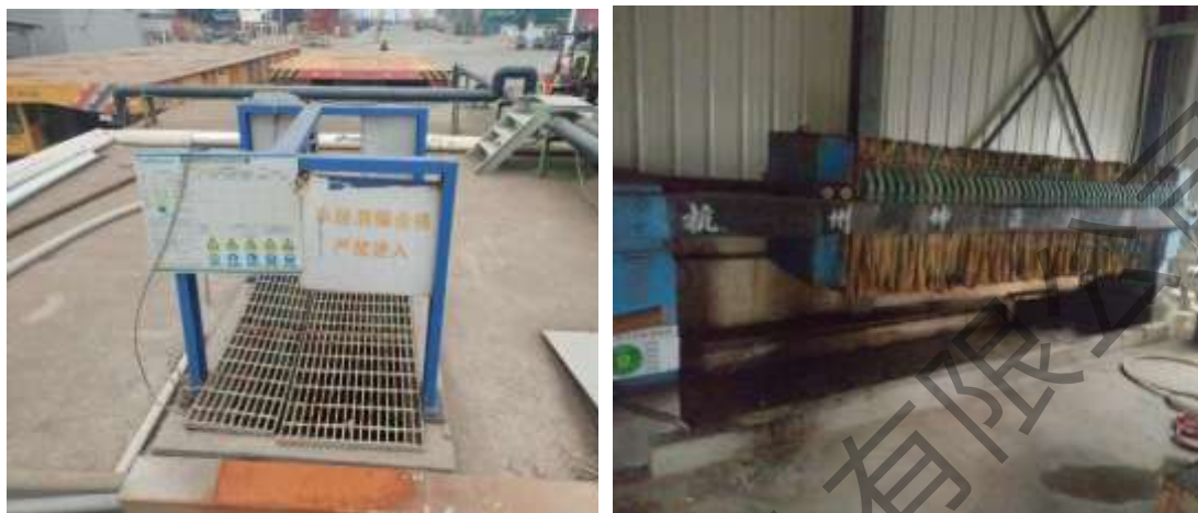
图 8.2.1-1 废水污染防治措施照片
