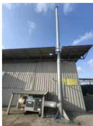
危废间排气筒
