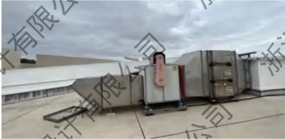
室内主体海水浴场屋顶排放口（白鲸宴会厅）
