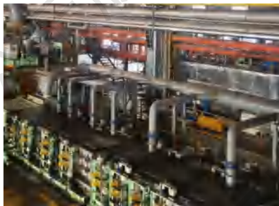
脱脂槽封闭集气
