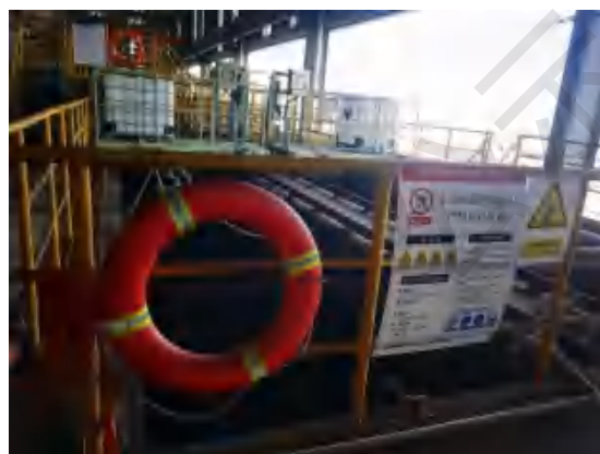
含油污水处理系统
