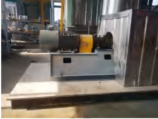
机泵固定减震
