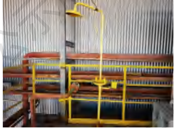
污水处理站应急设施
