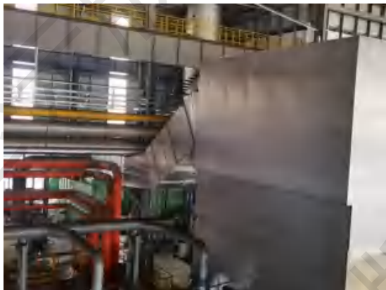
轧机油雾处理设施进口
