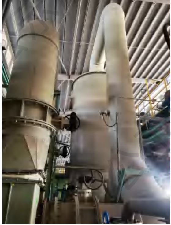
酸洗废气碱喷淋塔
