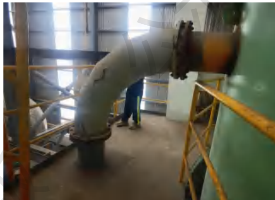
酸再生布袋除尘器进口
