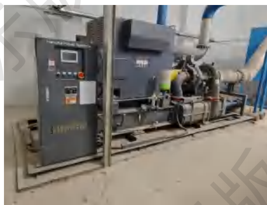
空压机位于室内
