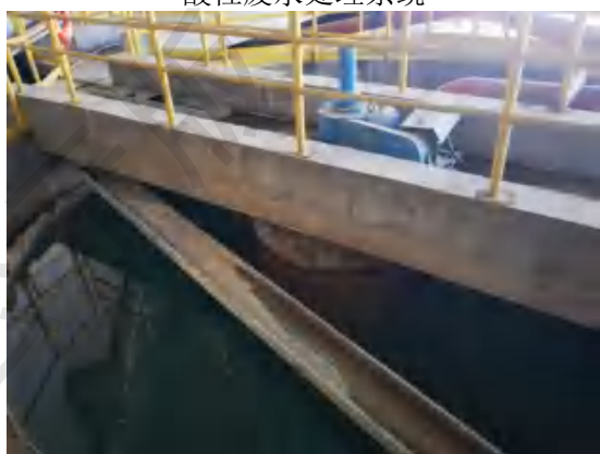
综合废水处理澄清池
