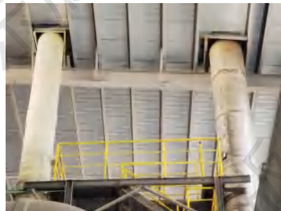
废气采样平台和采样口
