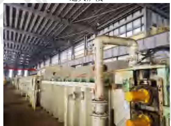
酸洗槽封闭集气
