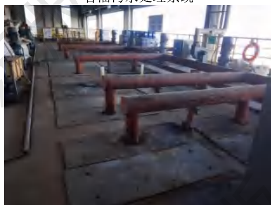
综合废水处理脱氮池、好氧池
