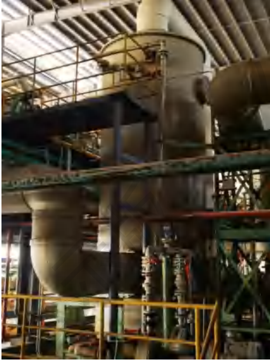
电解废气碱喷淋塔
