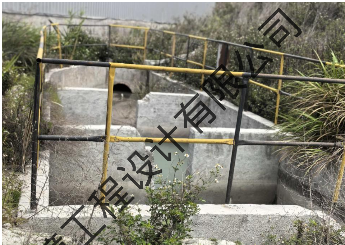
图6.2-10 码头后方陆域沉淀池
