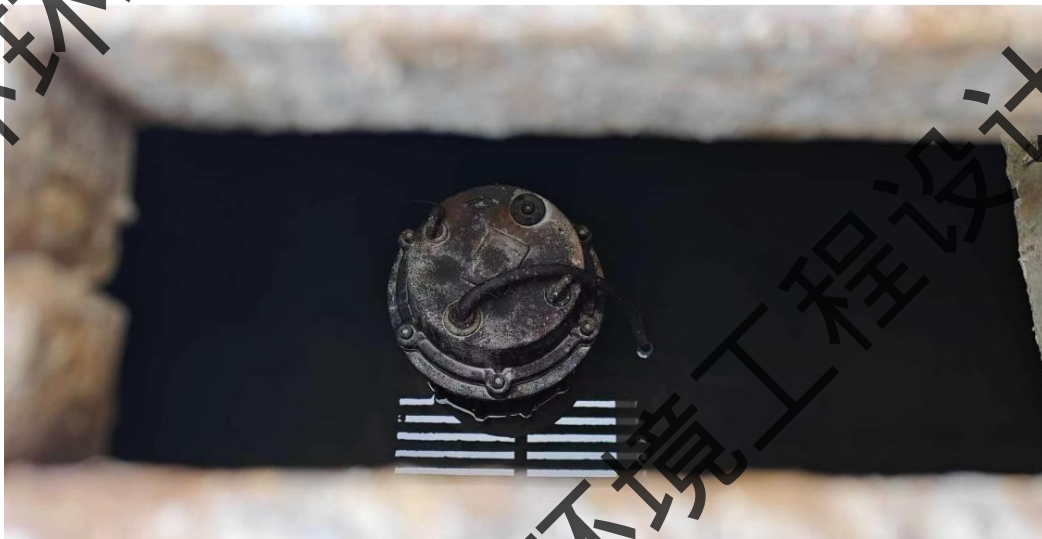
图6.2-9 码头雨水集污池
