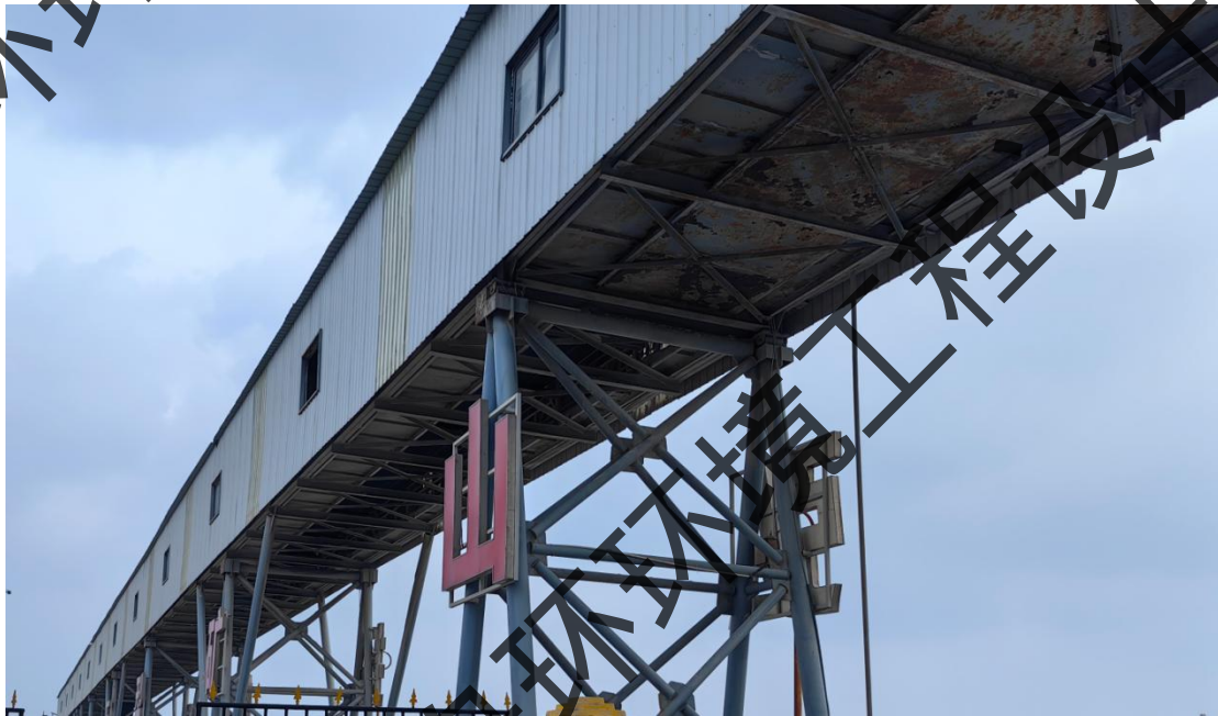
图6.2-5 封闭的栈桥段输送机
